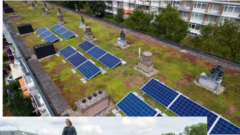
4. Dach z roślinnością, na którym zainstalowano panele fotowoltaiczne, źródło: Marloes Dout, “The Rotterdam Roofscape”, Międzynarodowa Konferencja „Adaptacja odpowiedzią miast na zmiany klimatu” Warszawa, 19.09.2018
